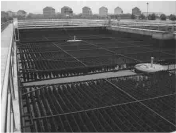
图 3 水蚯蚓生化池
